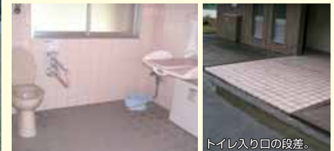
トイレ入り口の段差。
